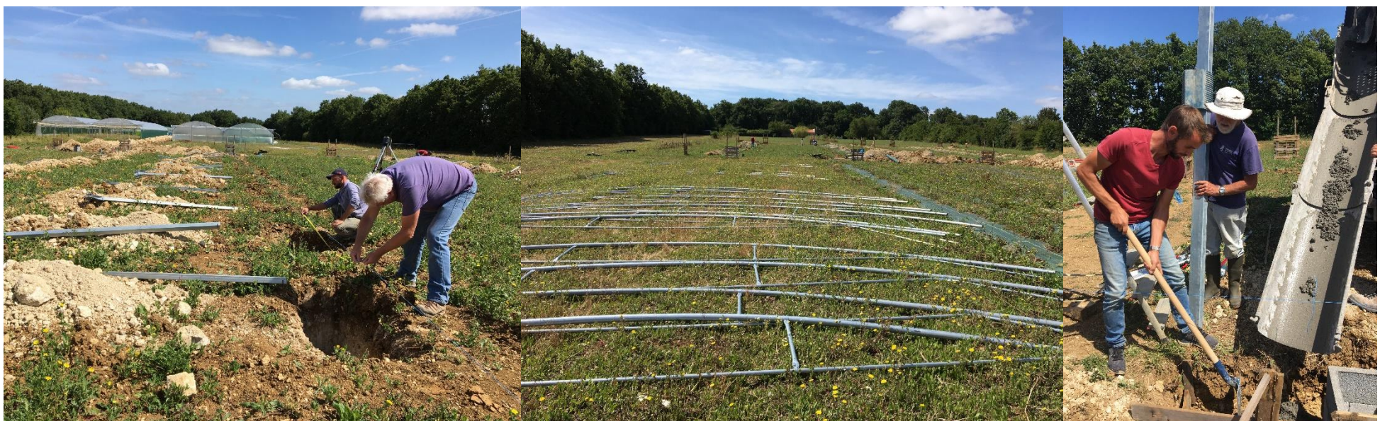
Mise en place de la structure des serres par Mario, Jacques, Dimitri et Philippe ( pour les premiers adhérents du Jardin, peut-être reconnaitrez vous Philippe, le 1 er chef de culture du Jardin, venu en renfort de Saint Nazaire. Merci à lui 😊 )
